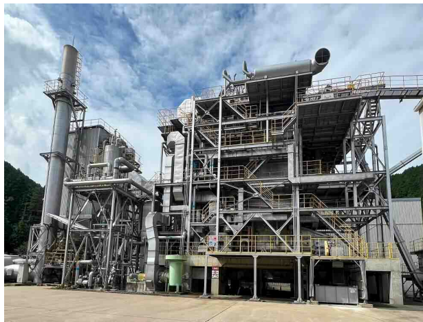
朝来バイオマス発電所
