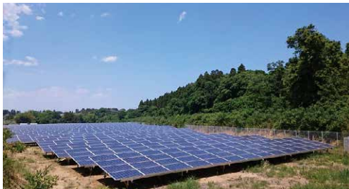
大和茨城第二発電所
