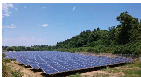
大和茨城第二発電所
