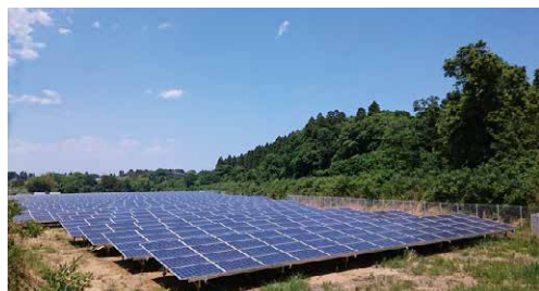
大和茨城第二発電所
