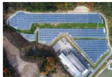
たつのメガソーラー発電所
