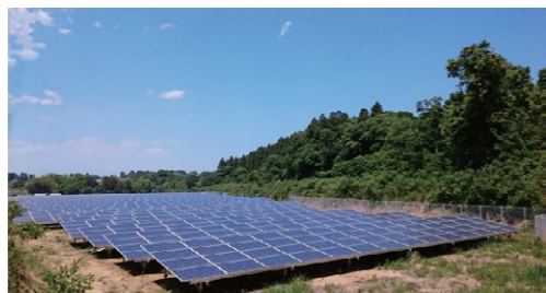
大和茨城第二発電所
