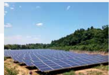
大和茨城第二発電所
