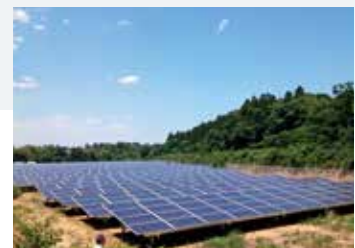
大和茨城第二発電所
